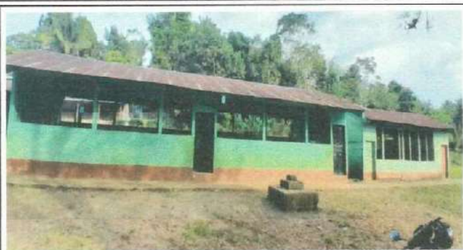
Foto1: En esta fotografia se evidencia que se necesita el cambio de techo.
